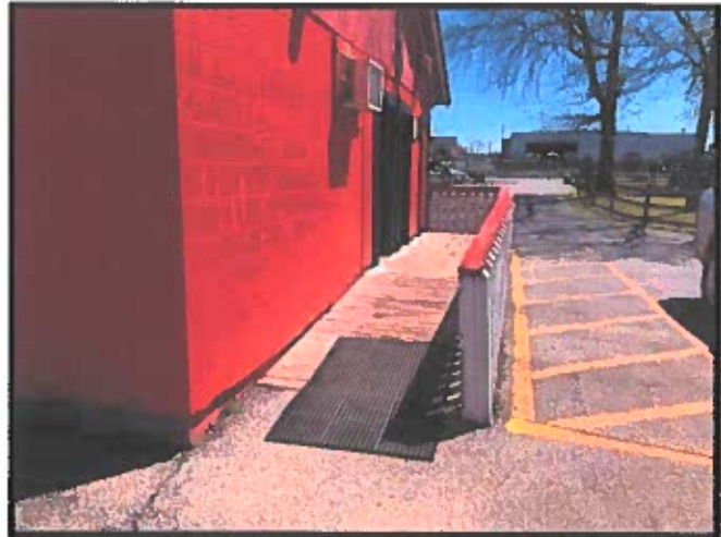
J.W. Johns Jr. Restroom Ramp Slope
